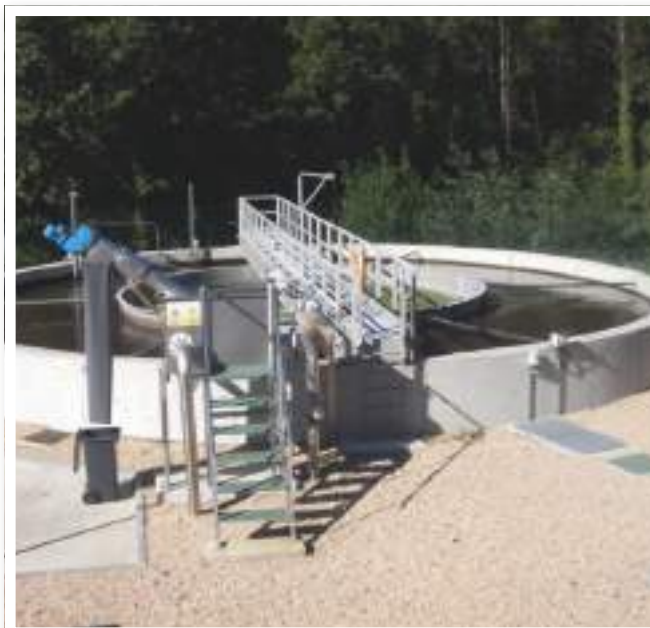
Aspecte d'una part de les instal·lacions de la nova depuradora que l'ACA ha posat en funcionament al terme municipal de Vidreres.
