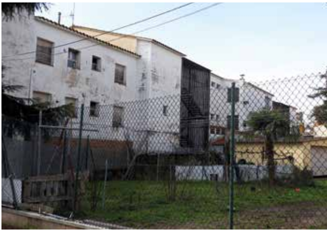
Actual estat de la façana posterior de l'escola Sant Iscle
